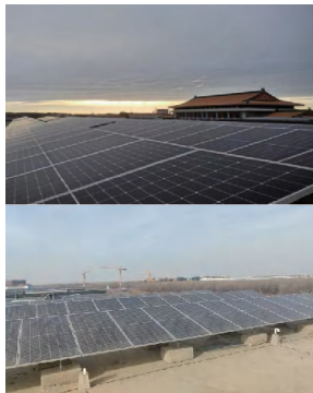
光伏发电设备
