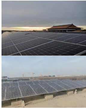
光伏发电设备
